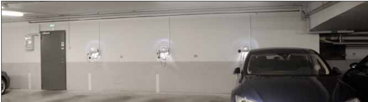
6 st nyinstallerade laddare i garaget hos Brf Sjöstadspiren som fått bidrag med 40 000:- från Klimatklivet
